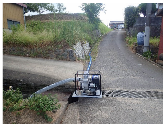
小型エンジンポンプ設置全景
