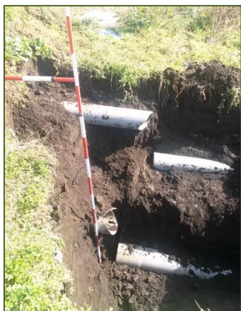
段差が生じ破損した管路
